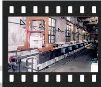
2004 年的综合 电镀生产线
